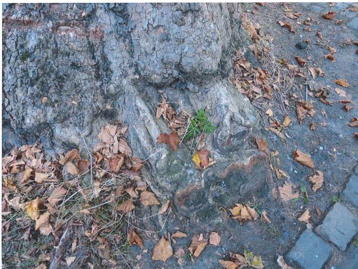
Foto 5: Mechanische schade aan stambasis ten gevolge van parkeerdruk (22/09/2016).
