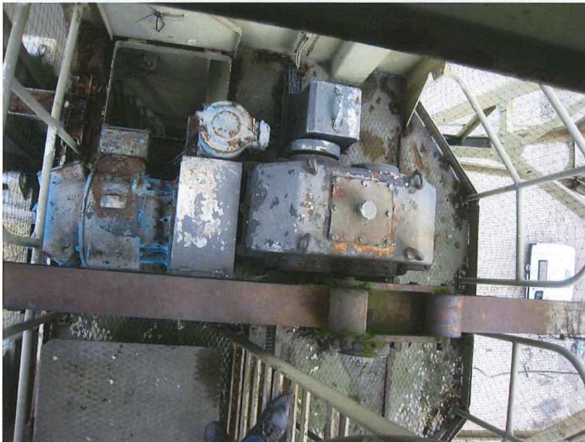
Foto's 31 en 32: Op het tweede niveau staat de topinstallatie van de kraan. Die bestaat uit een elektromotor die via een overbrenging een rondsel aandrijft en zo de tandheugel vooruit of achteruit beweegt. De leidrollen van de heugelstang zijn bovenop zichtbaar.
