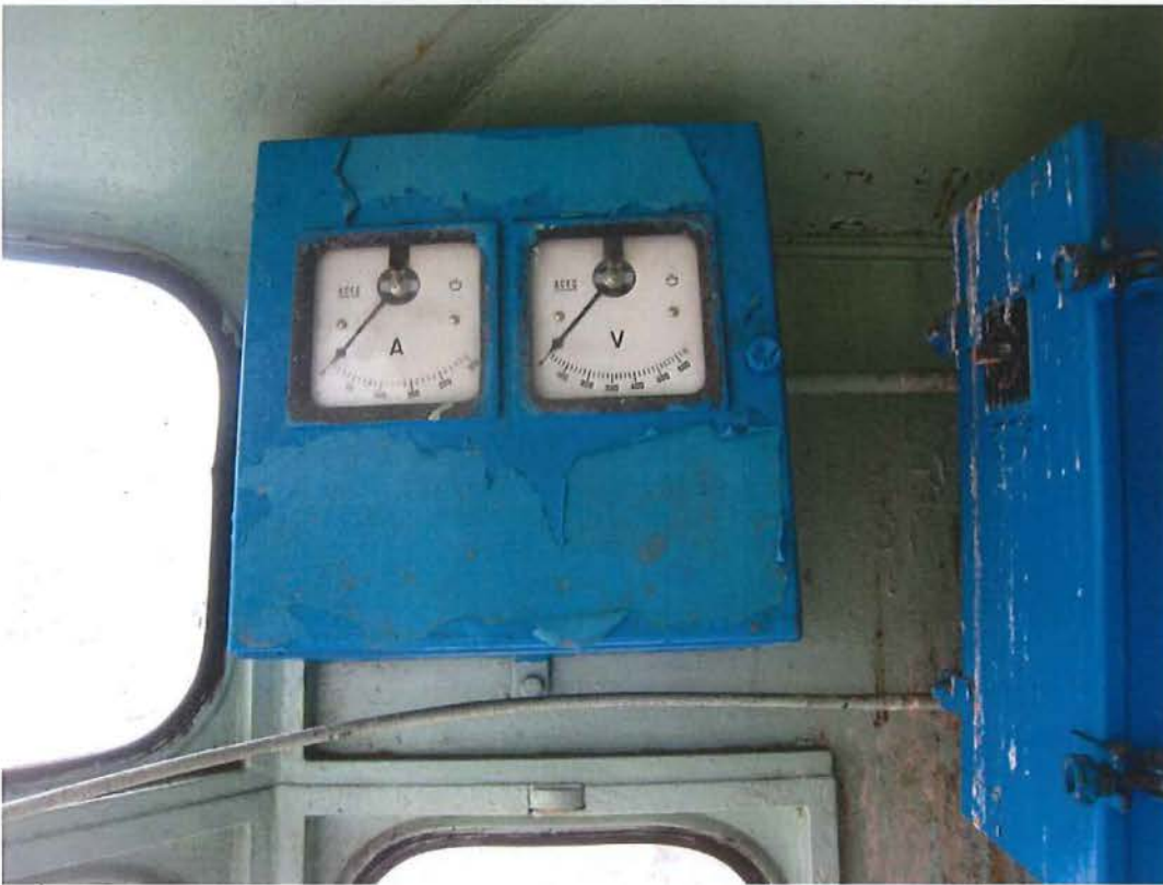
Foto's 26 en 27: De verwarming (foto boven) en enkele elektrische indicatoren (beneden) in de stuurcabine.
