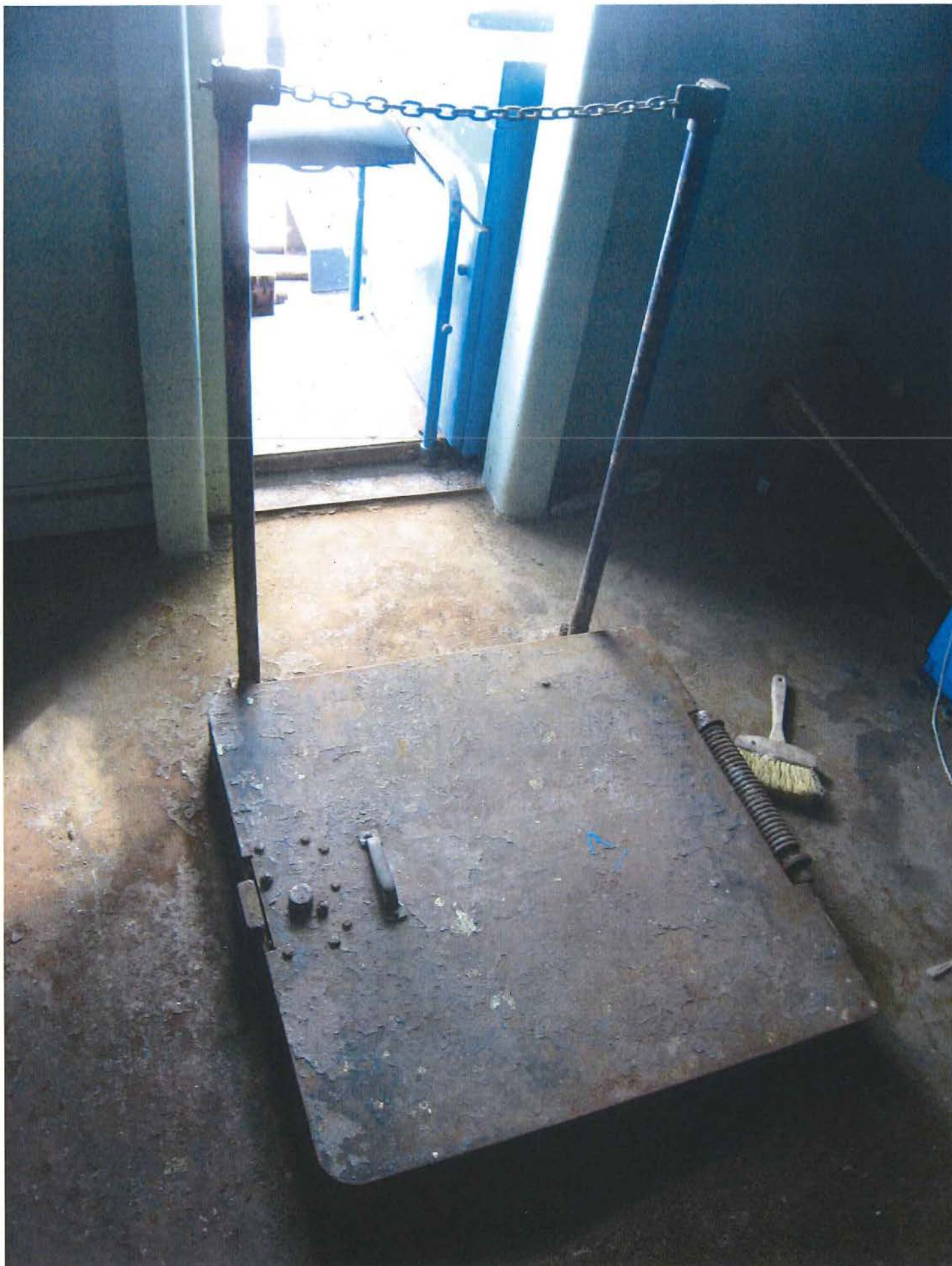
Foto 17: Het mangat met luik waarop de trap op het niveau van de machinekamer uitgaat.
