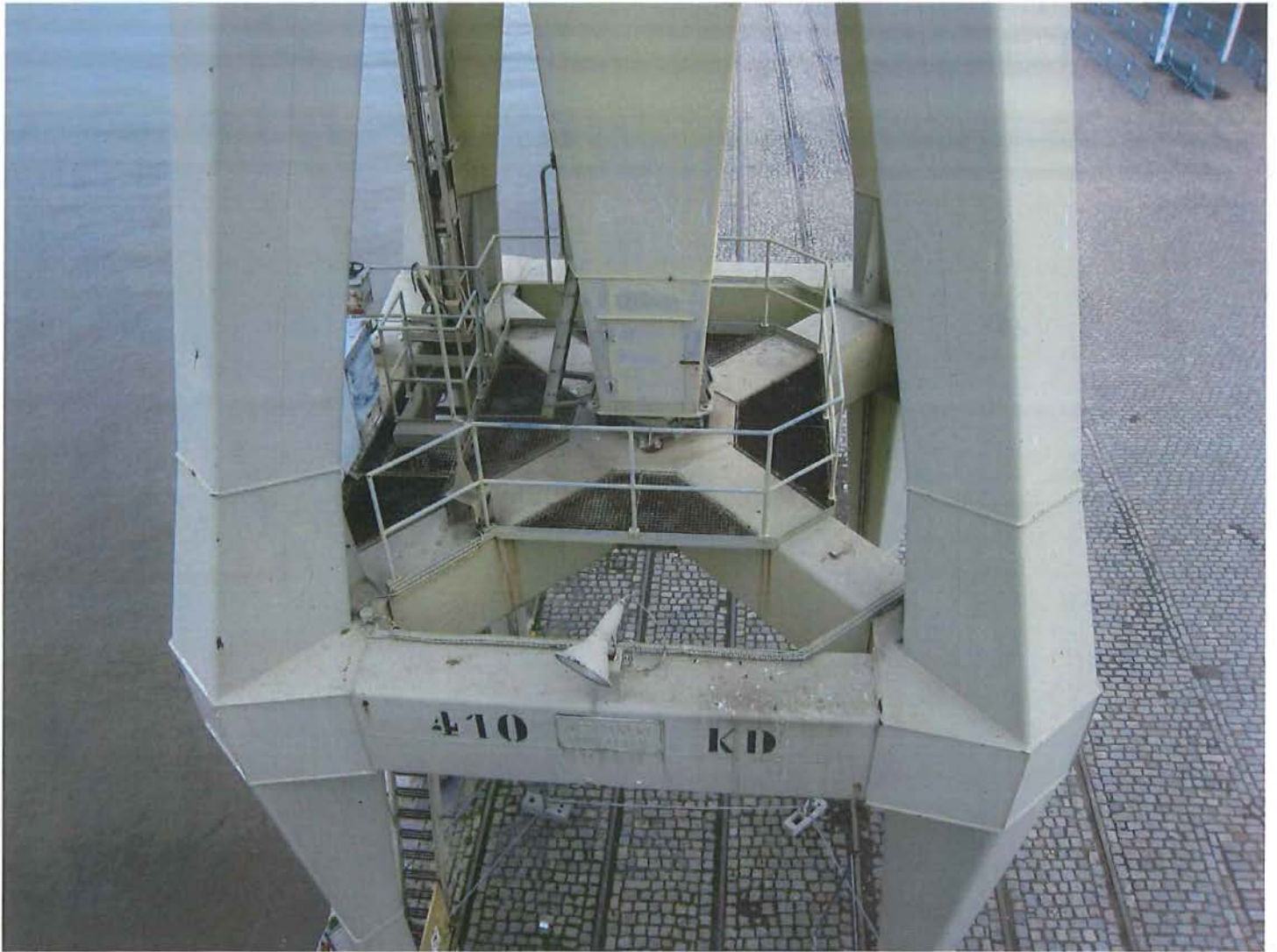
Foto 9: Het kruis dient als verstijving van de poten. In het midden draagt het kruis de zwenktaats waarop de zuil pivoteert. De taatslager vangt de verticale krachten van de draaizuil op en een deel van de horizontale reactiekrachten. Op het kruis is een bordes in roostervloer gelegd.
