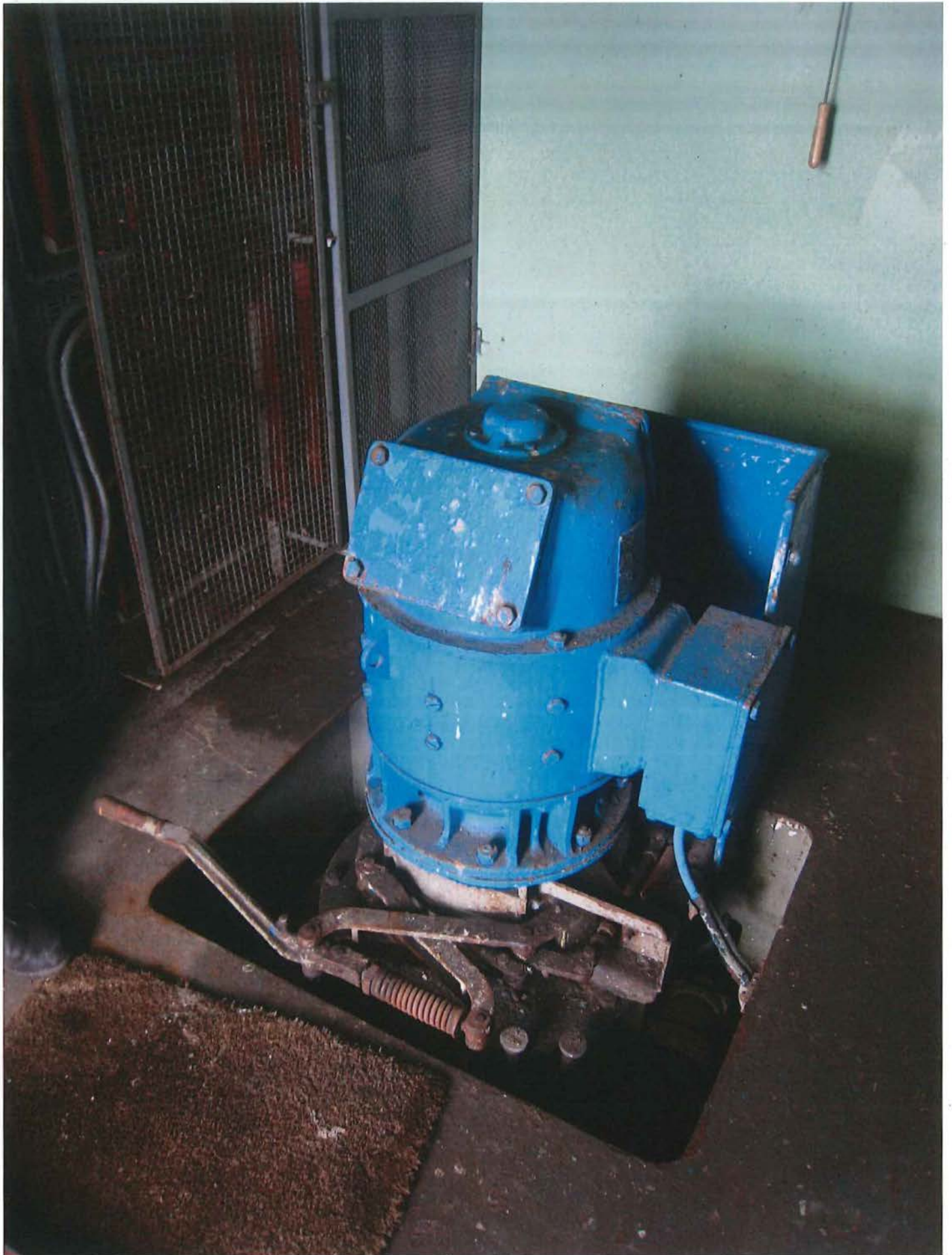
Foto 18: De elektromotor voor het zwenken van de zuil van de kraan staat opgesteld in de machinekamer.
