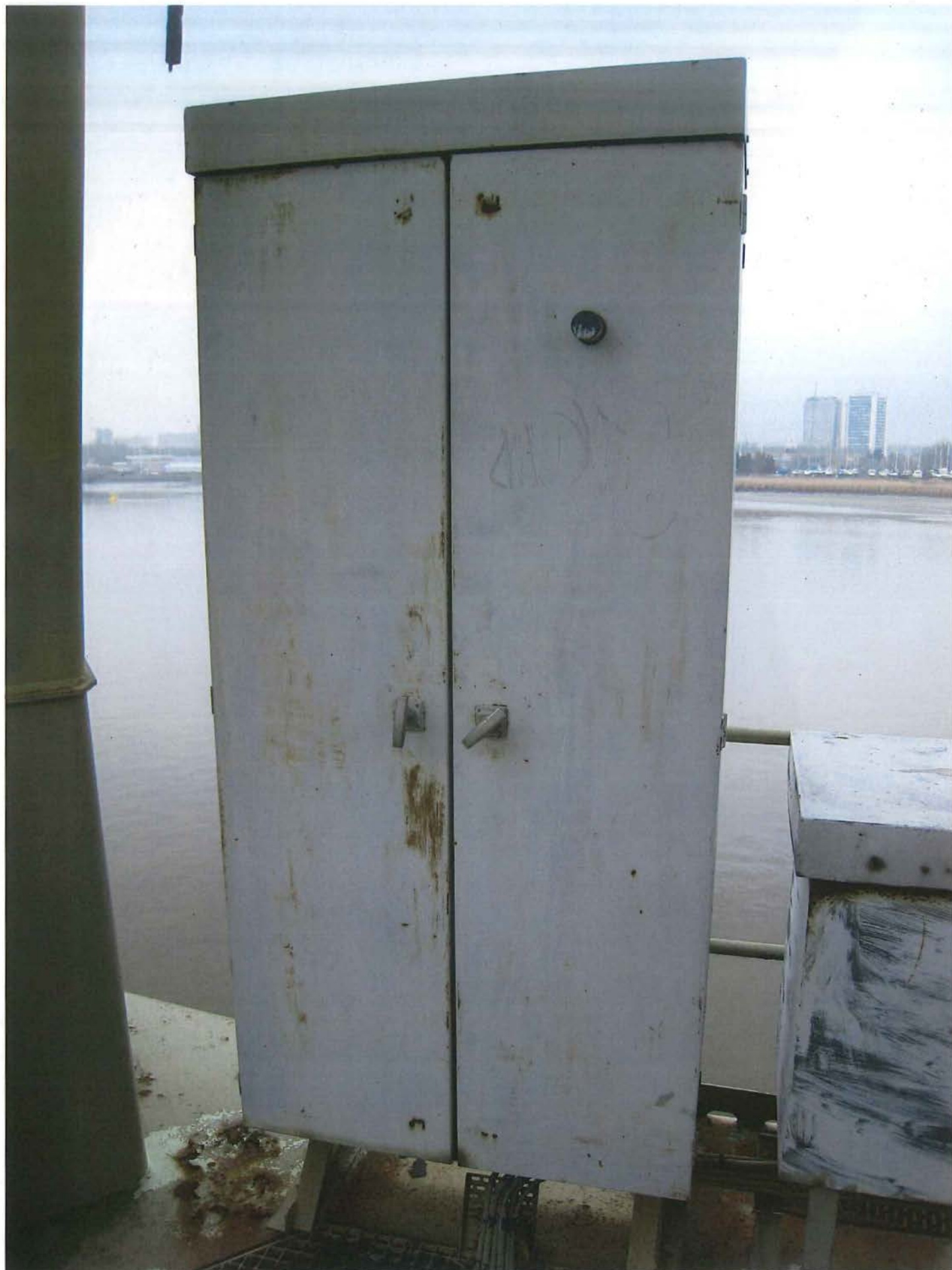
Foto 14: De contactorenkast op het bordes voor het kraanrijden.
