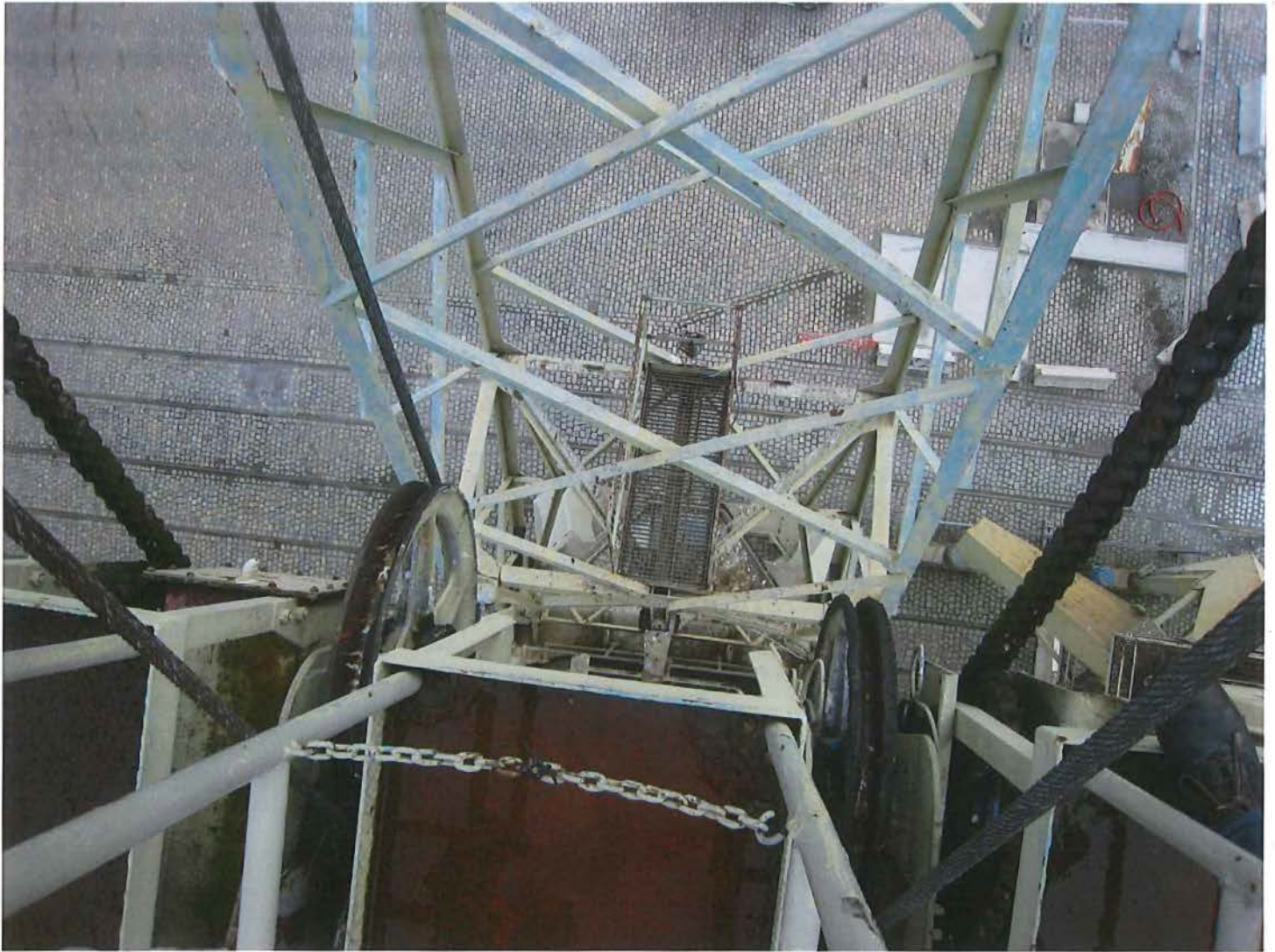
Foto 39: Vanop het platform aan de zijde van de giek zijn de twee volgende kettingwielen zichtbaar voor de geleiding van de ketting van het tegengewicht. De twee schijven zorgen voor de geleiding van de hijskabel. Rechts op de foto loopt de hijskabel van de trommel naar de top van de giek om daar via een keerschijf terug te lopen naar de keerschijf links op de foto. Die schijf geleidt de kabel naar de top van de giek.
