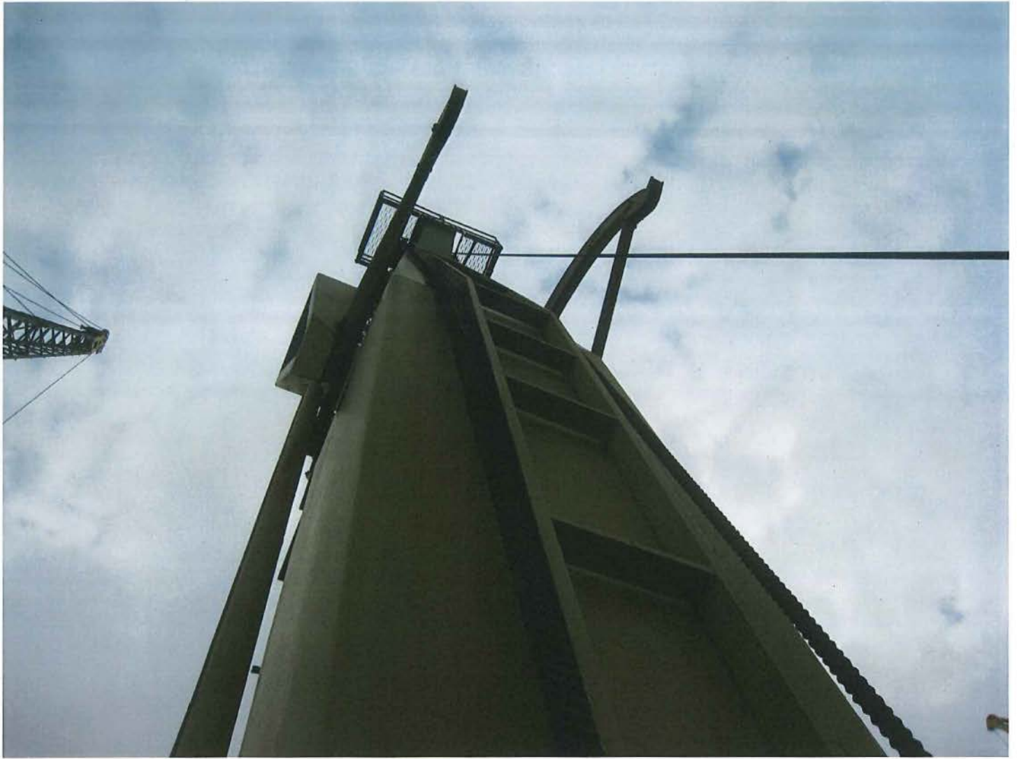
Foto 12: De glijbaan van het tegengewicht met de fleyerkettingen waaraan het tegengewicht is opgehangen.
