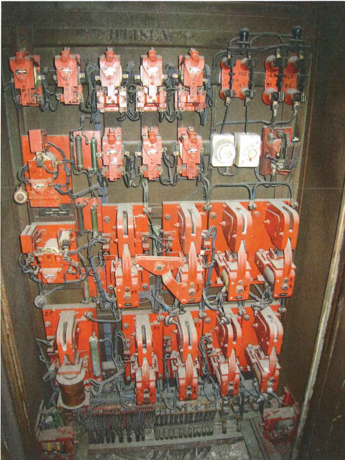
Foto 17: De elektrische schakelapparatuur en weerstanden zijn binnen in de toren zelf opgesteld.
