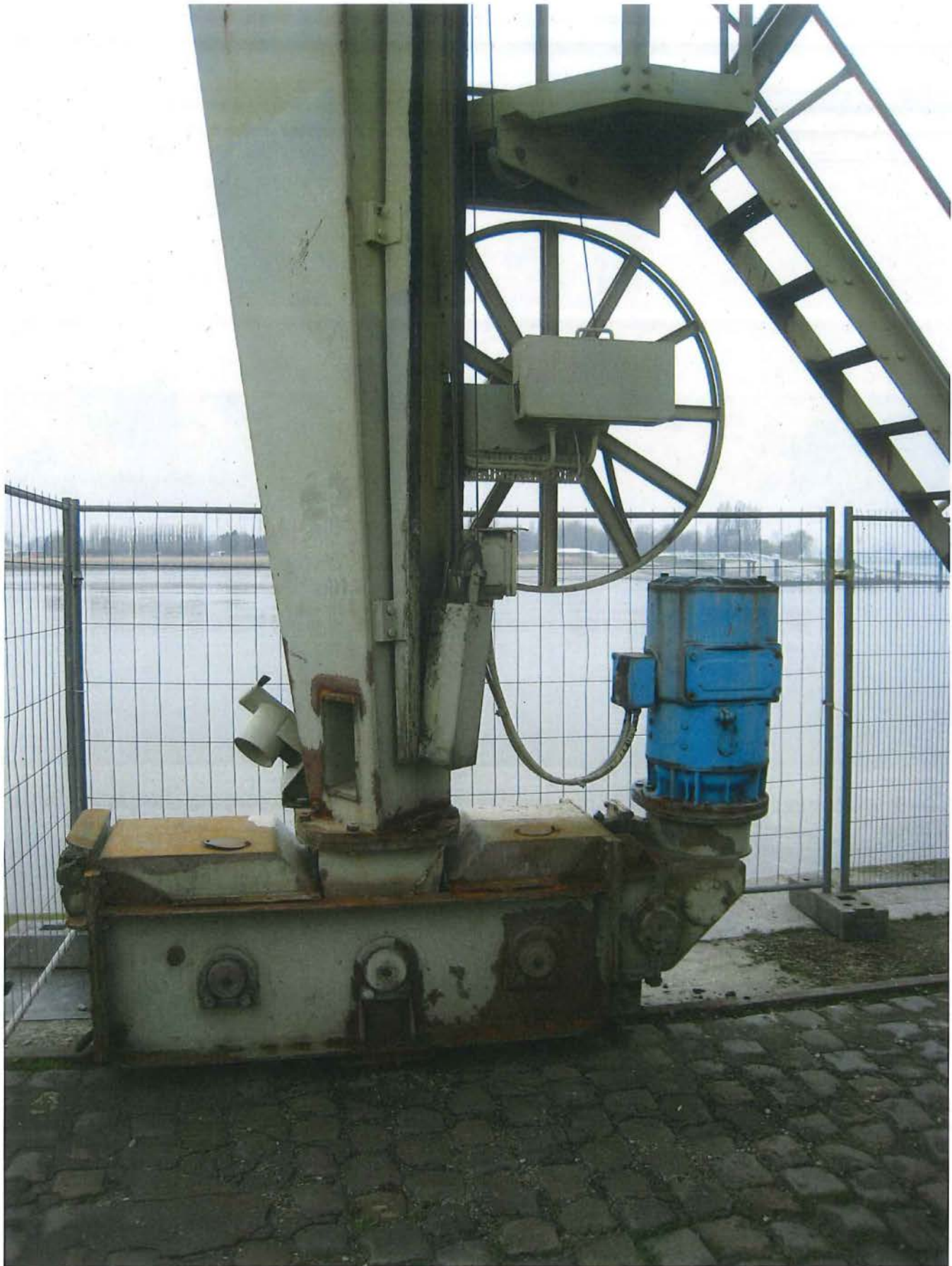
Foto 4: Bogie met aandrijving, de spoel voor de kabel (niet aanwezig) om aan te sluiten op het elektriciteitsnet en de ladder naar het eerste bordes tussen de poten.
