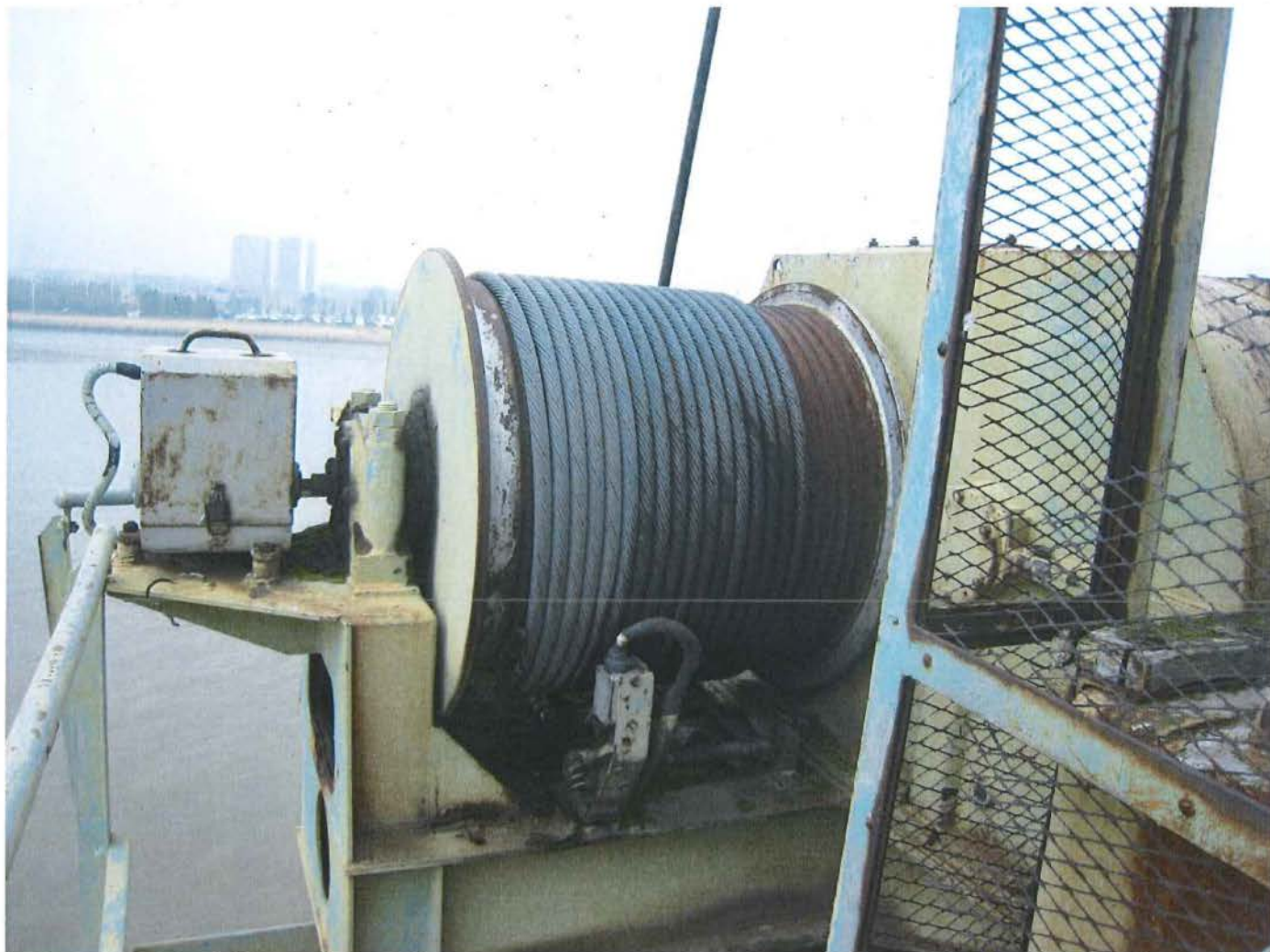
Foto 9: De trommel van de hijskabel op hetzelfde bordes.
