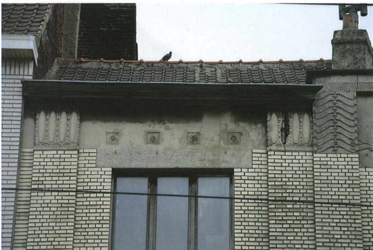
Foto 4: Voorgevel Hundelgemsesteenweg. Detail decoratieve cementering en houten kroonlijst.
