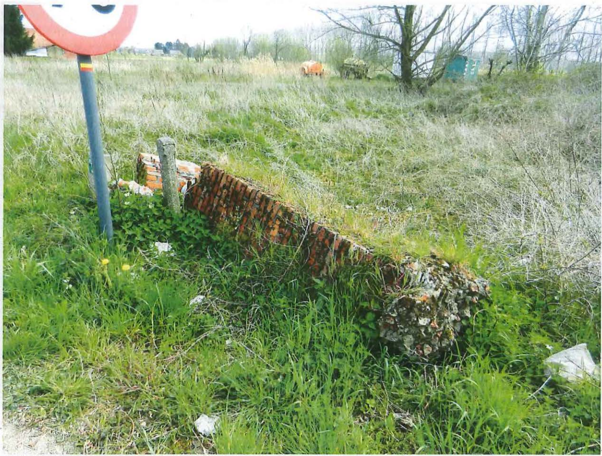
Foto 19: omgevallen oostelijke pijler van de poort aan de Heirweg.
