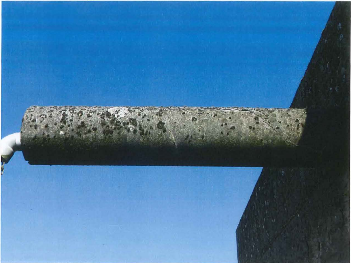
Foto 23: Achtergevel hoofdgebouw, eerste verdieping. Detail van de buis van de waterafvoer met barsten.
