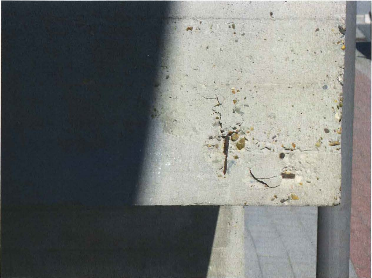
Foto 13: Voorgevel hoofdgebouw. Sporen van betonrot.
