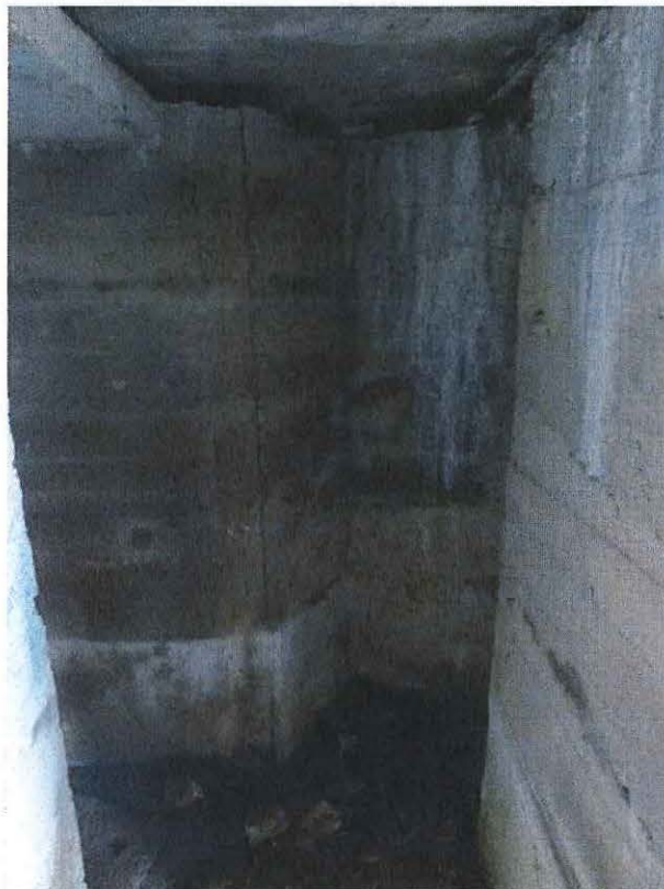
Foto 6: Een bijkomende nis in de westelijke hoek van de gang voor het plaatsen van een toiletton.
