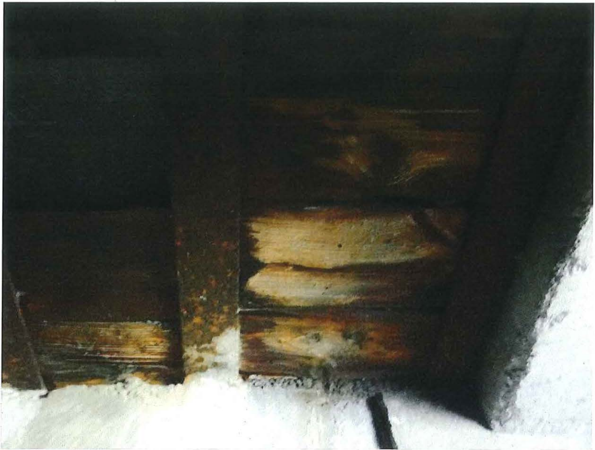
Foto 7: Bewaarde houten beplanking tussen de stalen profielen in het plafond van de bunker.
