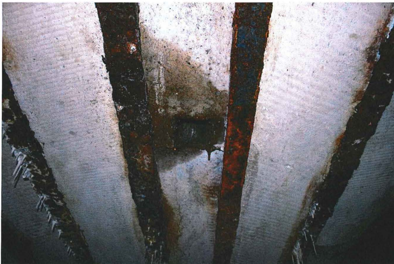
Foto 5: Een kleine opening in het plafond.
