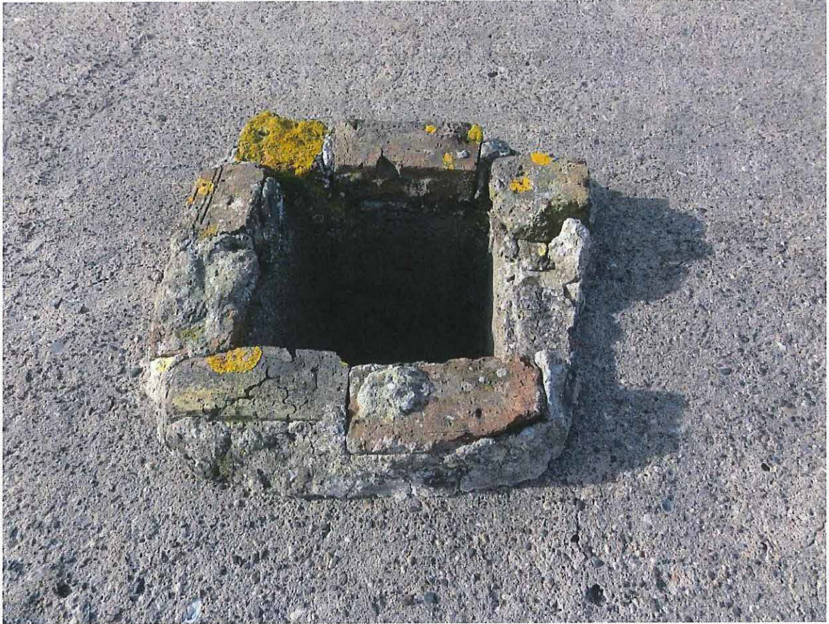
Foto 7: Bakstenen rond de opening in het dak.
